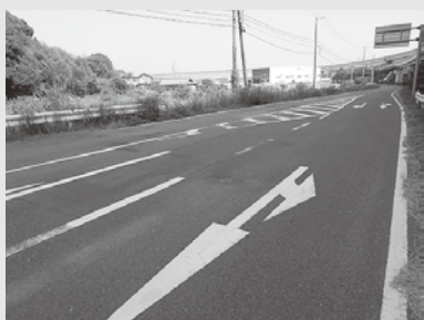
▲舗装損傷のある町道4-16号線
