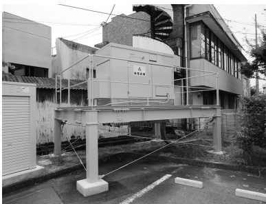
保健福祉センターに設置された自家発電機
